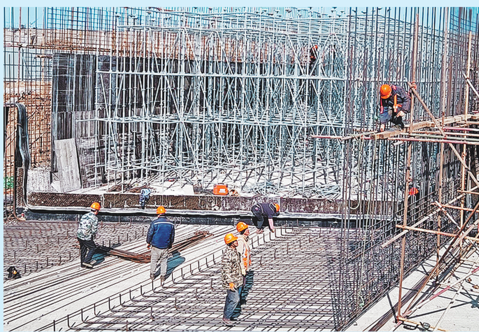
五公司潍烟铁路项目部复工复产顺利进行。图为工人正在进行钢筋绑扎作业。
