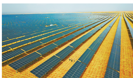
三名项目员工穿行在太阳能板间检查。
