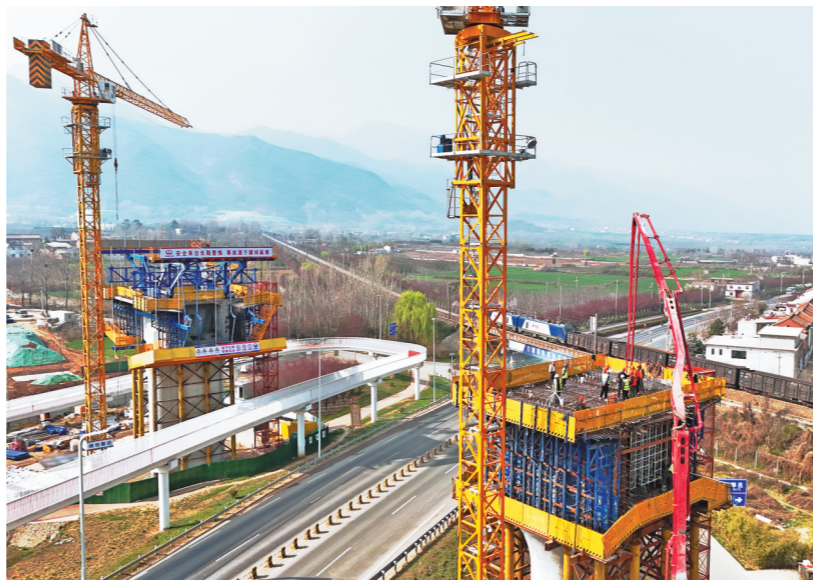
西康高铁关中环立交特大桥7号~10号墩因跨越S107省道而设，设计为(40+64+40)米连续梁，其中0号块施工难度较大。为此，项目部对混凝土质量、混凝土运输、混凝土浇筑过程进行全面控制，落实每一处细节。图为3月22日，关中环立交特大桥8号墩0号块浇筑现场。
