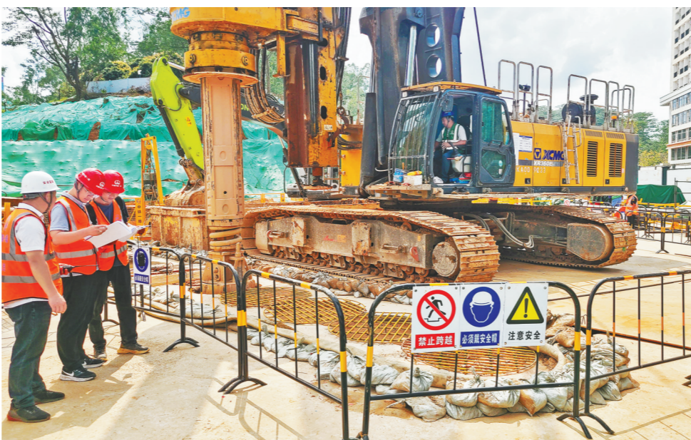
3月18日，在建设者的欢呼声中，深圳地铁22号线一期工程鹭湖站围护结构开始桩基施工，这也是全线开工的首个站点，标志着22号线土建设工拉开序幕。 通讯员 卢旭 张登云 摄影报道
