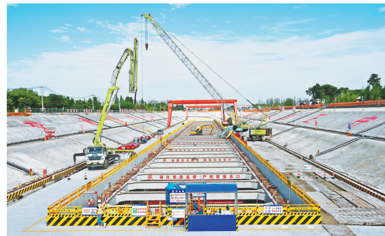
近日，中铁一局沪渝蓉高铁项目一分部机场隧道进口四仓明挖隧道进行仰拱垫层浇筑，标志着四仓施工重大工序转换顺利完成，正式转入主体施工工序。
